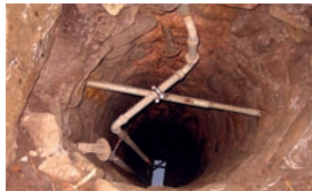
Korrodierte Rohre, starke Eisenoxidausfällungen
