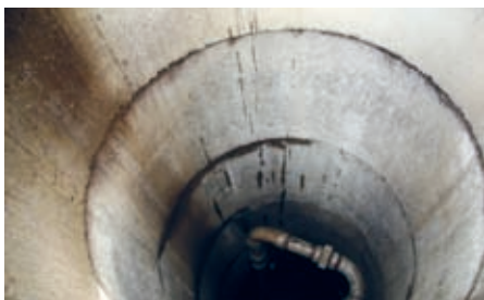
Feuchtigkeitseintritt zwischen Schachtringen
