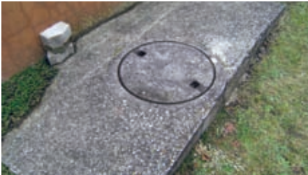
Risse in der Betoneinfassung führen zu Undichtigkeiten
