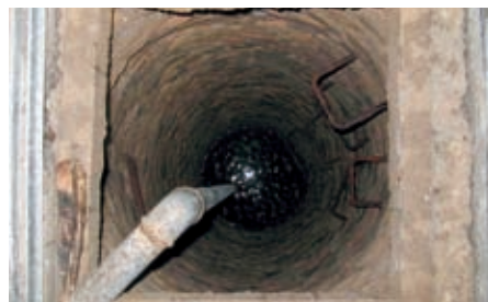
Eisenteile in Schachtbrunnen
