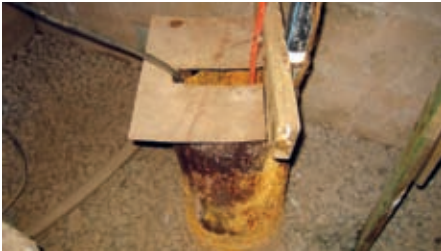
Mangelhafte Abdeckung Brunnenrohr
